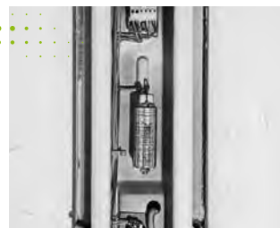
LES PETITS CONDENSATEURS DANS LES RAMPES D'ÉCLAIRAGE (FABRIQUÉS ENTRE 1950 ET 1984)
