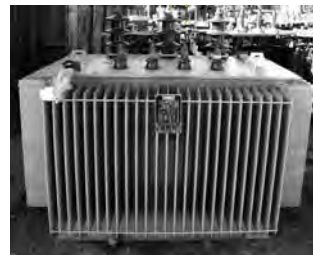
LES TRANSFORMATEURS (FABRIQUÉS AVANT 1986)
