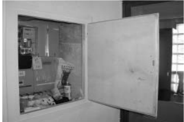
Coffret de disjoncteur avec plaque de protection anti-feu contenant de l'amiante à l'intérieur de la porte, photo IST
