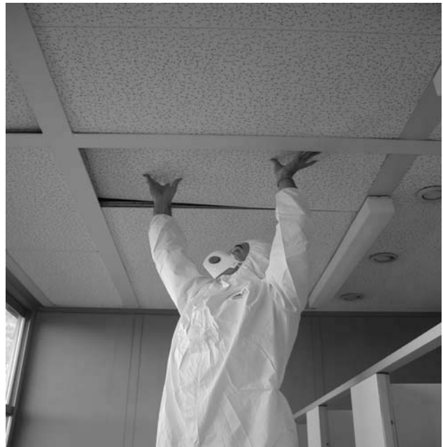
Faux plafond contenant de l'amiante, photo IST
