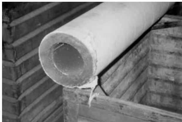
Calorifugeage contenant de l'amiante, photo IST
